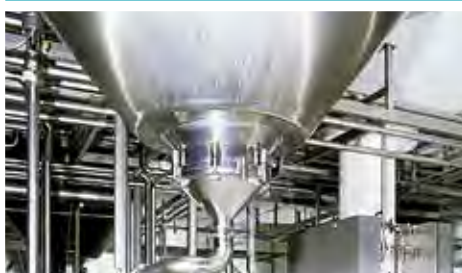
Tanques y contenedores
